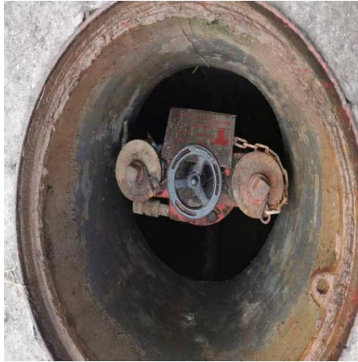
室外水泵接合器现状图
