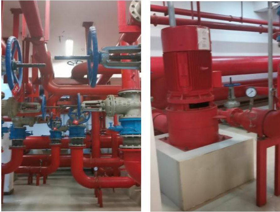
消防泵房内水泵及管道安装现状图
