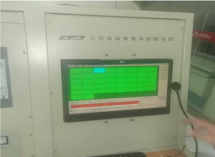
消防控制室图像显示装置现状照片
