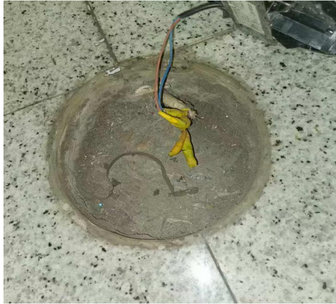
共享大厅地面疏散指示灯具现状照片
