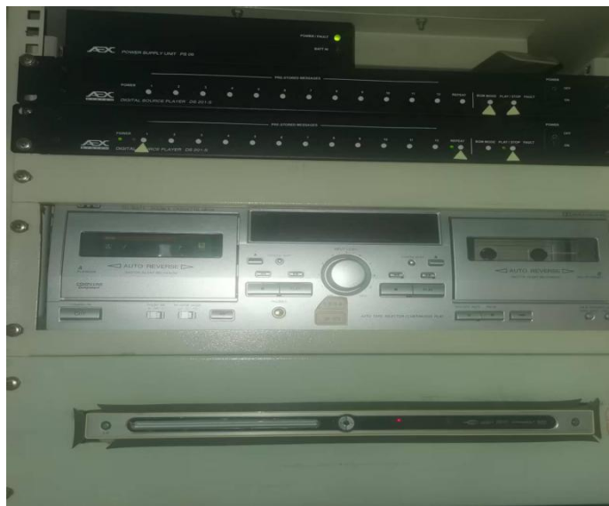
消防控制室消防广播音源设备现状照片
